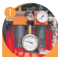
1 Tratamiento de aire/ Treatment of air
