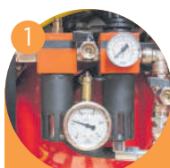
1 Tratamiento de aire / Treatment of air
